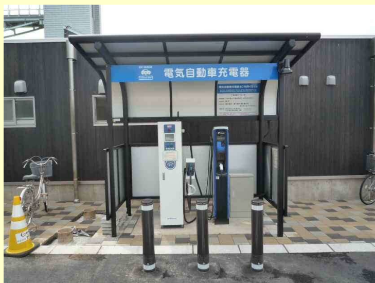
EVステーション
