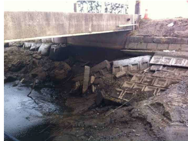
名取市(鈴木堀)排水路護岸崩壊(H24.12.18撮影)
