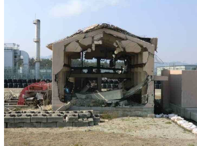
山元町 花笠第二排水機場(H24.10.22撮影)
