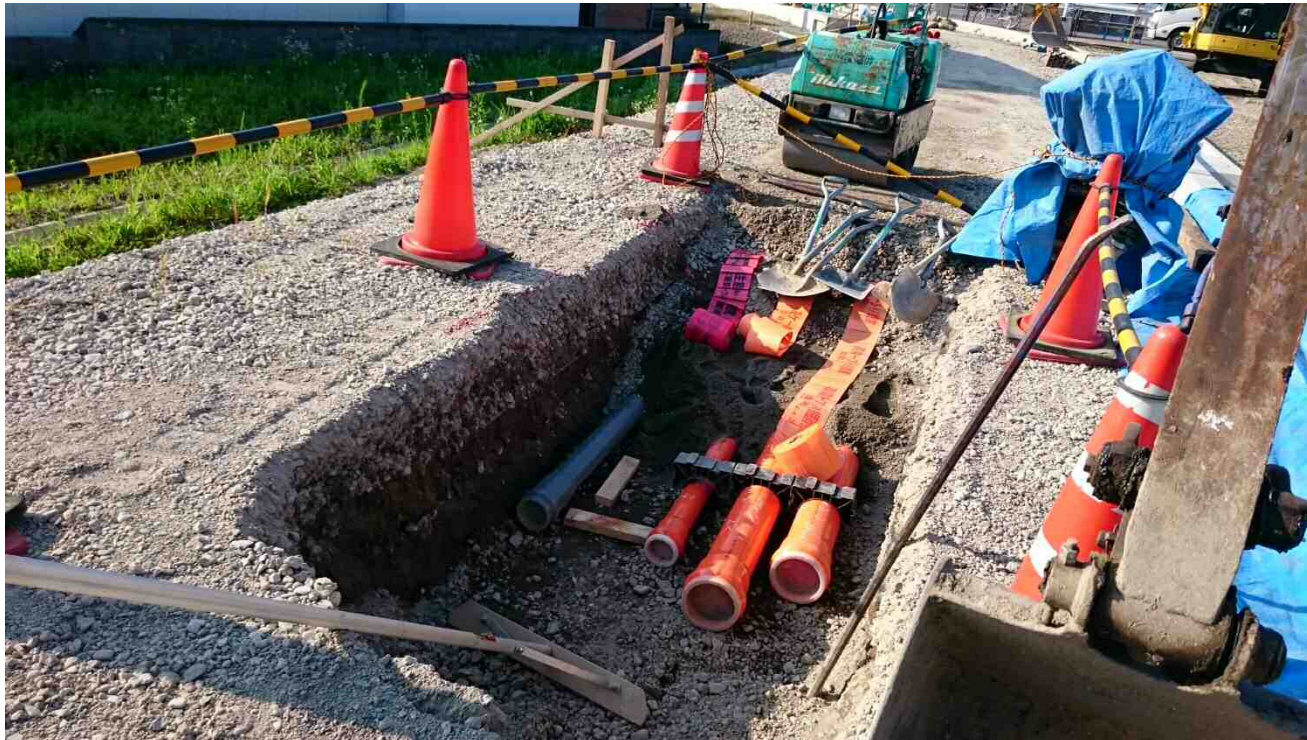
電力・通信事業者埋設管
