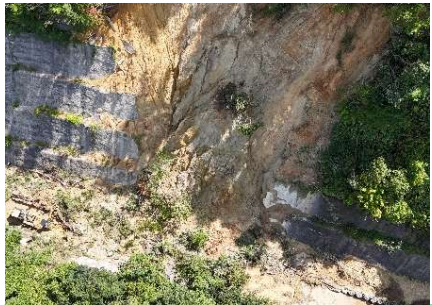
9月24日 若山町 市道崩落箇所
