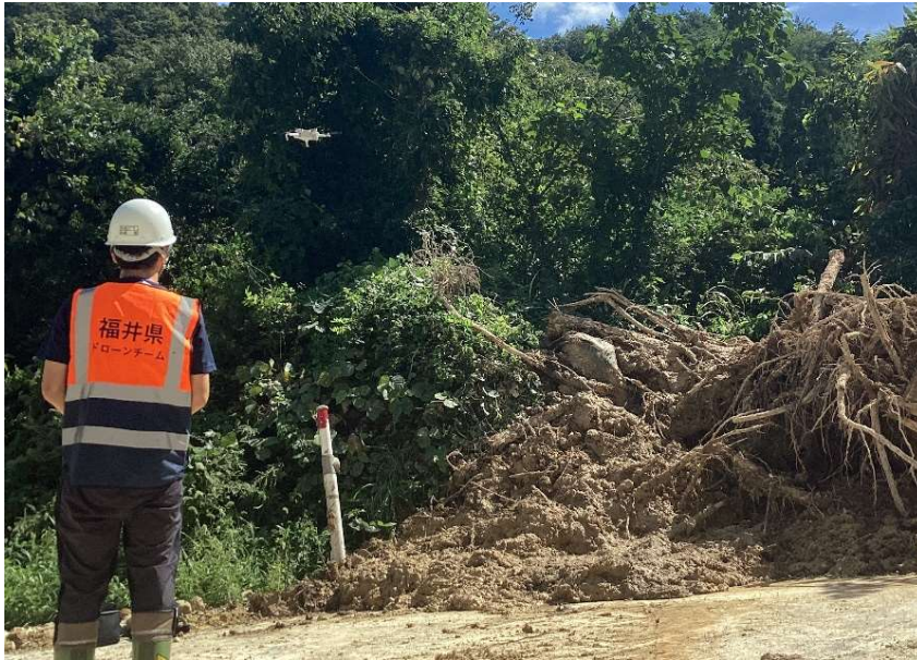
9月24日 ドローン撮影状況 市道崩落箇所
